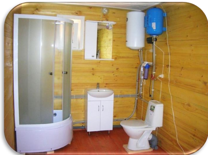
Водоснабжение ГВС/ХВС с автоматикой
