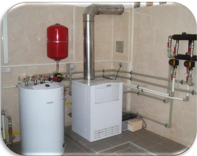
Отопление и ГВС на природном газе
