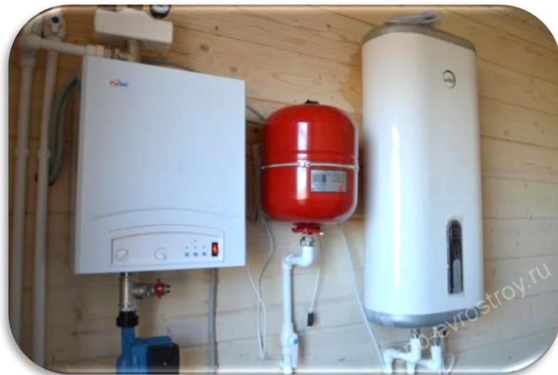
Отопление и ГВС на электричестве
